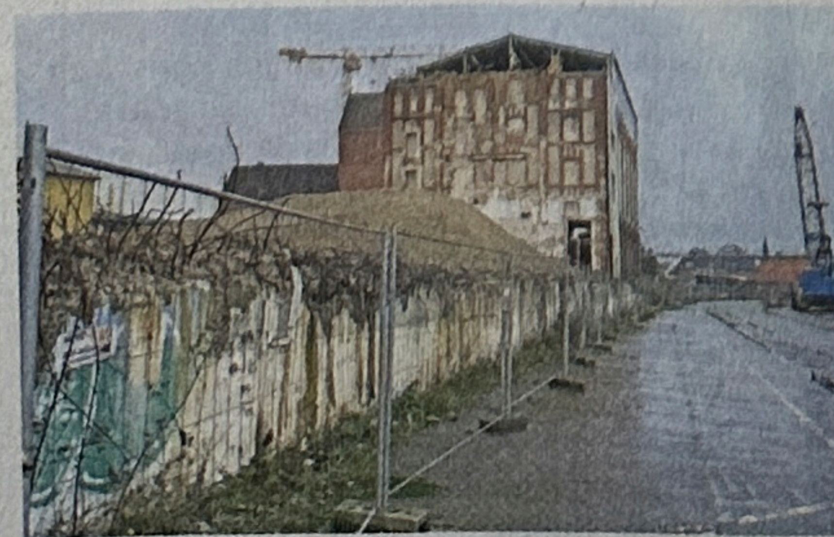
Noch ist Neustadts Hafenvestseite eine Baustelle. Rund um die Speichertürme im Hintergrund entsteht das neue Quartier.
